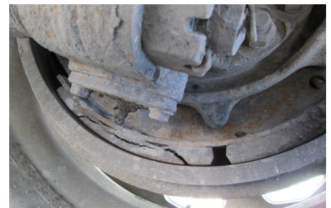
Garniture fissurée. M.H.S., Partie II, a.(5)(c)iii / 393.47(a)-U.S.
